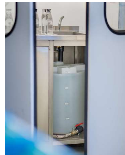
DEPÓSITO DE REUTILIZAÇÃO DE ÁGUA
